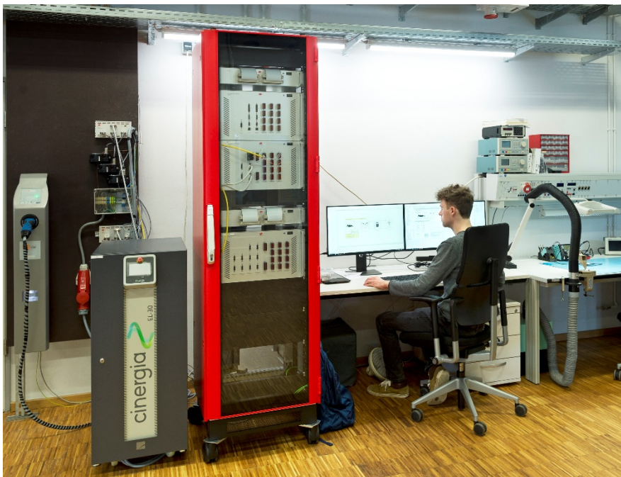
Ladestationen können auf ihr Verhalten in verschiedenen Netzsituationen hin getestet werden. © Fraunhofer ISE
